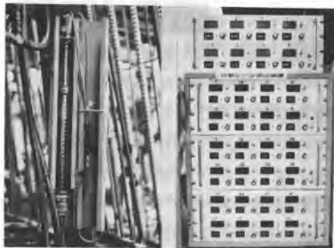
写真2. レベルセンサーと自動レベル管理装置 ととなる。
