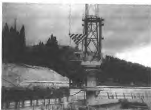
写真-1 自動運転状況
