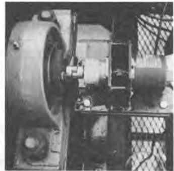
写真3 センサー設置状況
