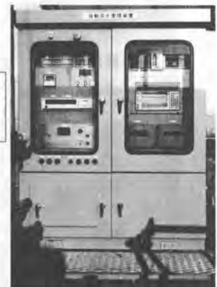
写真-4 自動泥水管理装置
