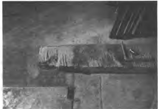
写真6 床面付近の切れ残り部
