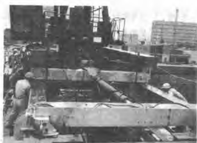
写真-4 トラベリング装置
