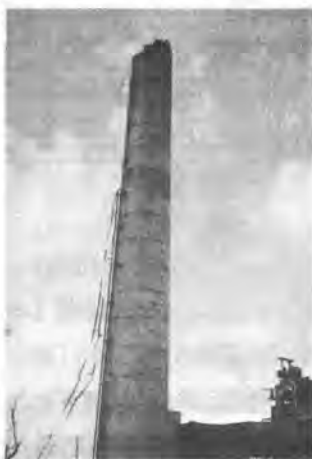
写真-1 地震で上部が折損・倒壊した煙突
