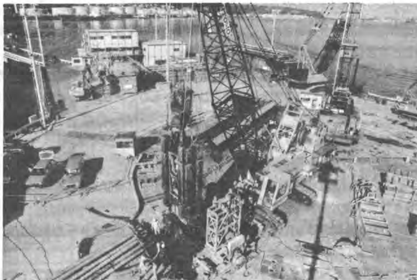
写真-1. 精度管理装置設置状況
