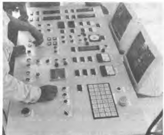
写真-2 制御装置
