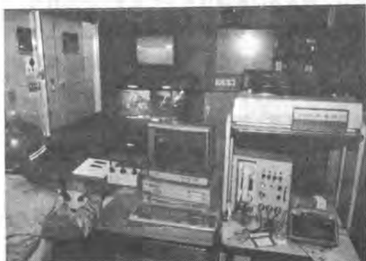
写真-1 遠隔操作室
