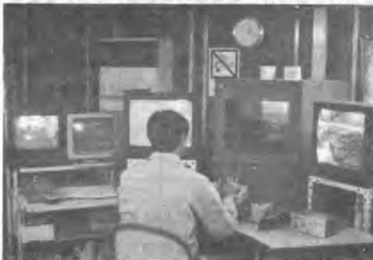
写真-1 地上管理制御室内 操作状況
