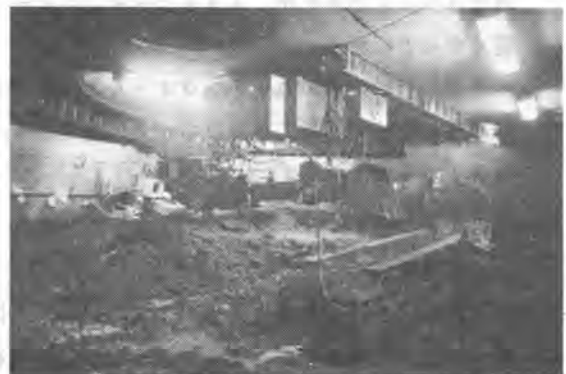
写真-2 圧気作業室内 機械設備
