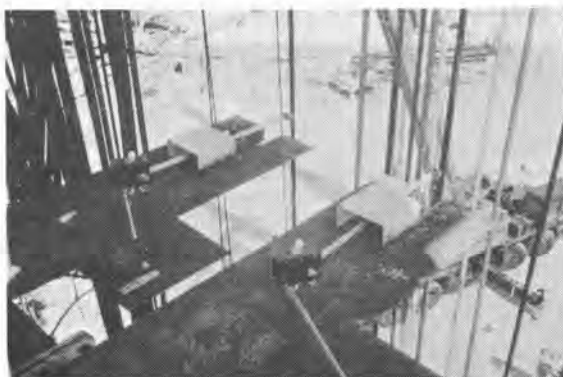
写-3 中心位置検出装置
