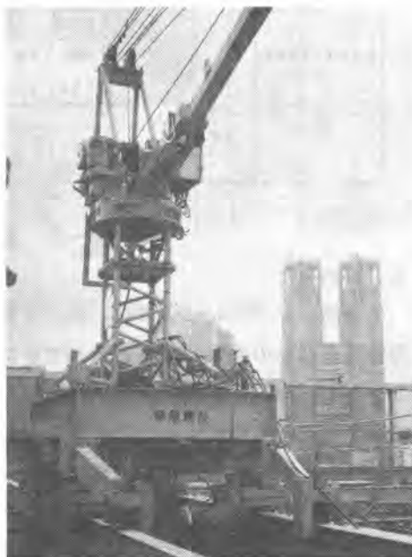
写真・1 屋上走行クレーン 2号機
