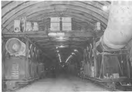
写真-1 コントラファン全景
