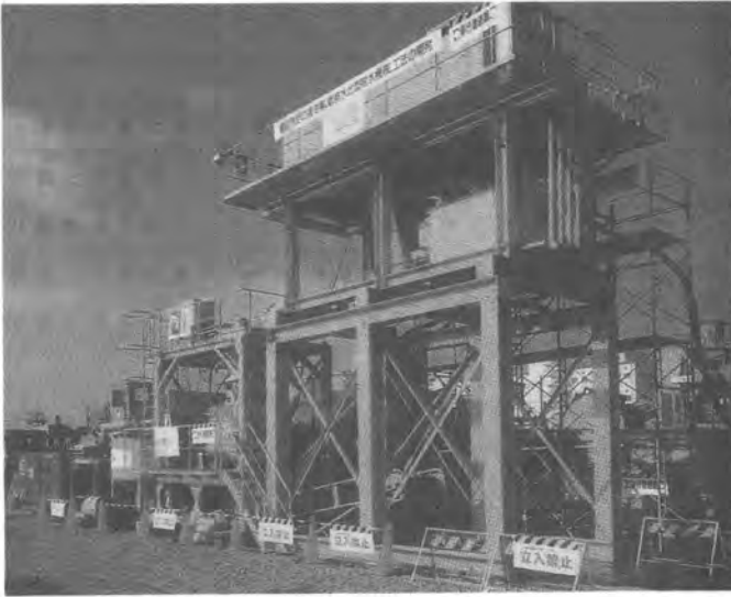
写真 - 1 システムの全景
