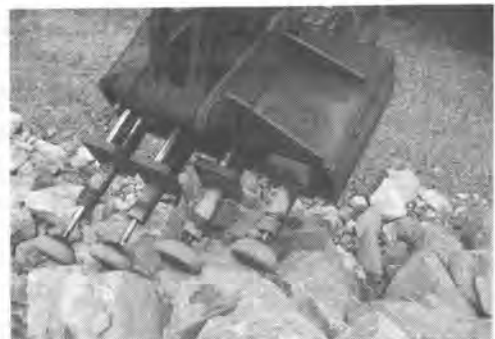
写真-3 不陸部での状況
