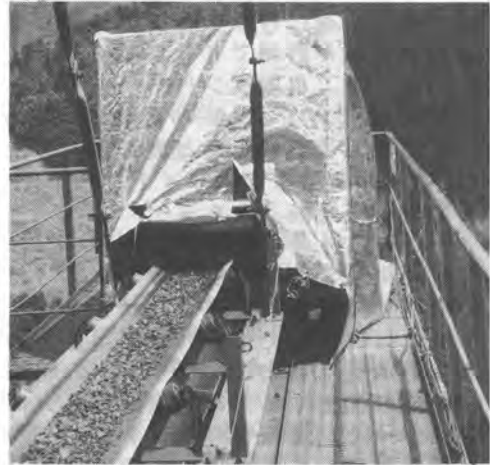
写真-1 カメラ架台
