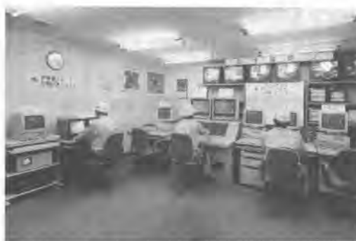
写真-10 中央操作室
