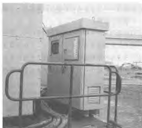
写真-2 集中管理制御装置
