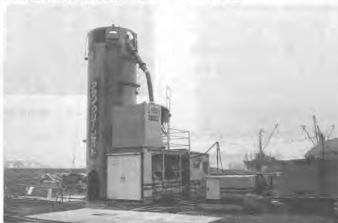
写真-1 全自動ミキシングプラント
