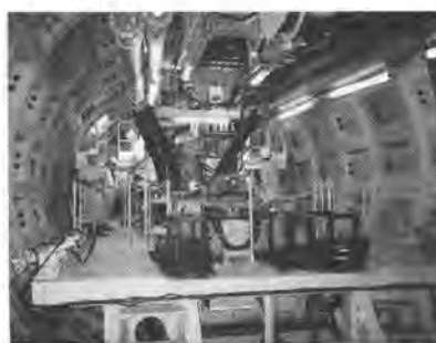
写真-2 供給コンベアーの作業床
