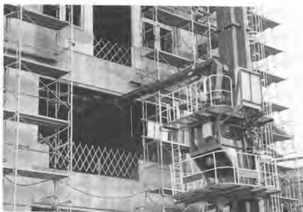
写真-2 建物内への差し込み
