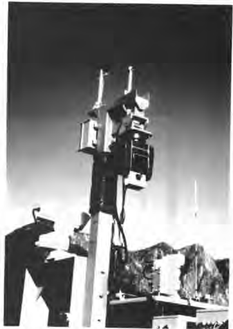
写真-3. 無線中継車に装備したアンテナ群
