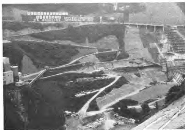
写真-1 設備全景(コンクリートプラント・ベルトコンベヤシステム)
