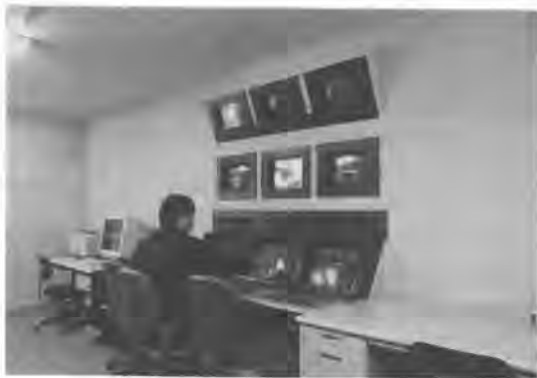
写真－2 中央制御室操作状況
