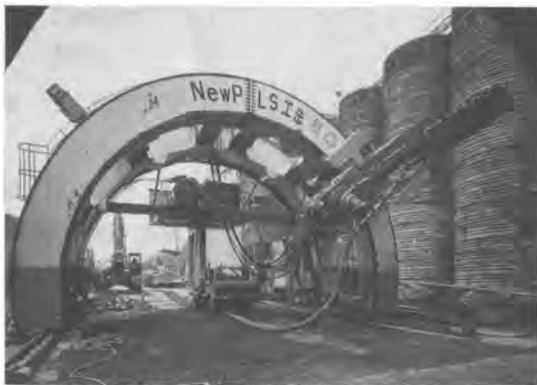
写真-1 New PLS機の全景
