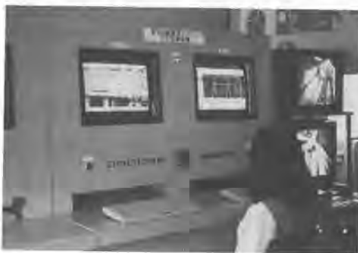
写真-3 中央制御装置
