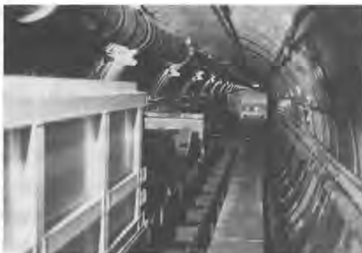
写真-2 坑内自動運行状況
