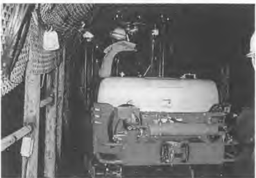
写真-2 油圧装置の外観
