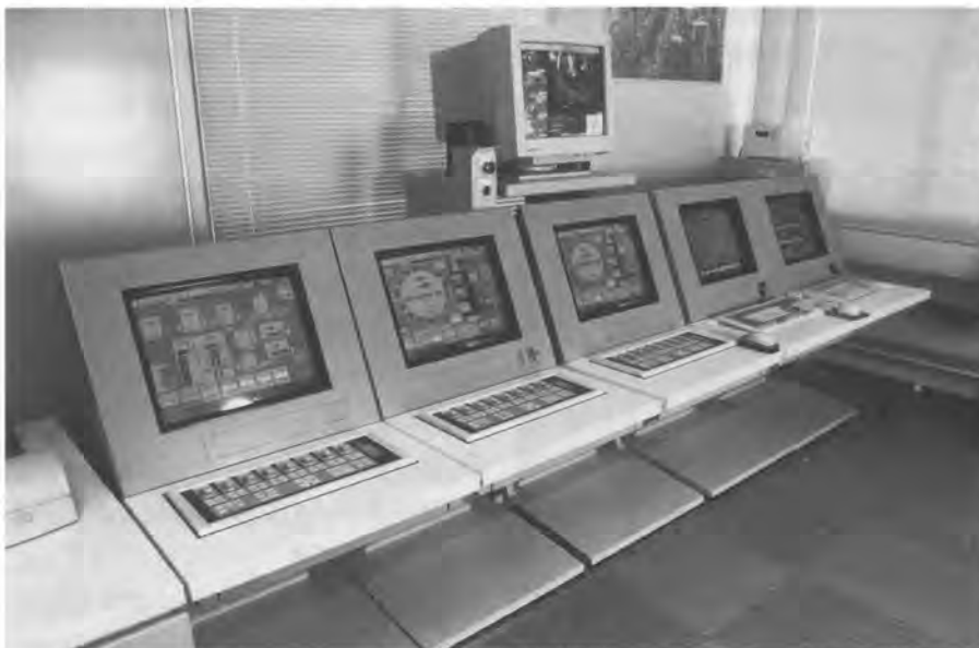
写真-1 統合制御室
