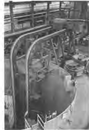
写真-3 立坑搬送装置
