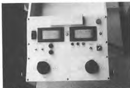
写真-2 コンクリートスプレッド操作盤
