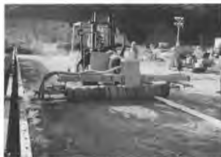
写真-1 除水・止水装置
