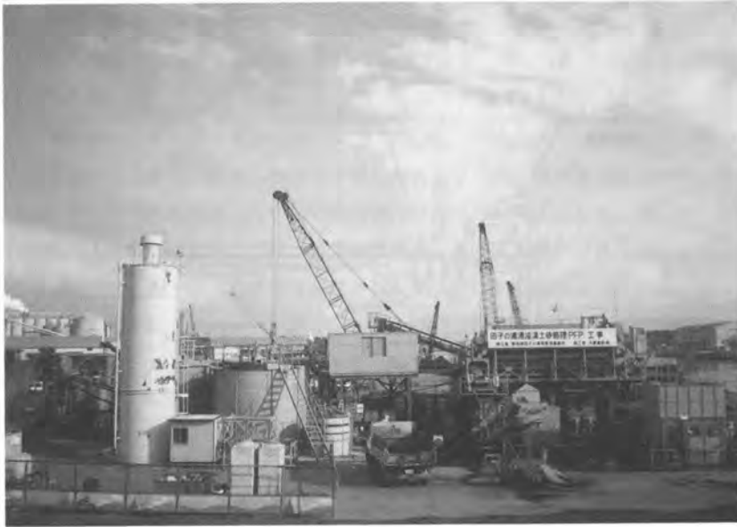
写真-1 プラント全景
