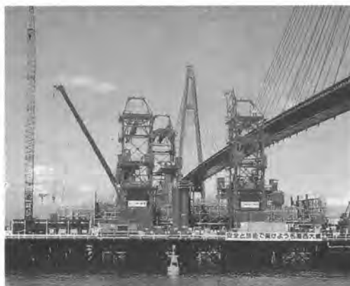
写真-1 地上設備全景
