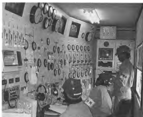
写真-6 管制室操作状況
