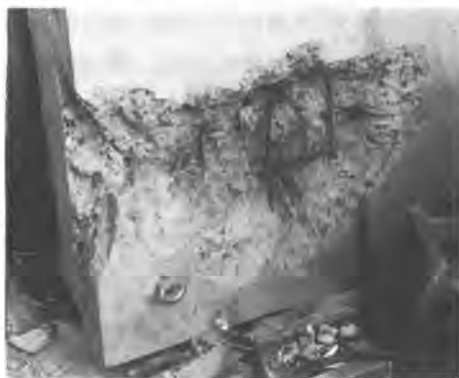
図14 鉄筋コンクリートの破碎例 II
