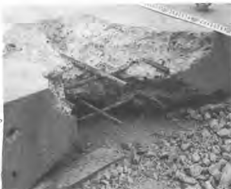
図13 鉄筋コンクリートの破碎例 I
