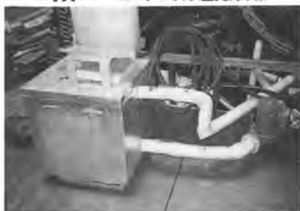
写真-2 循環ポンプ部
