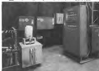
写真-3 リザーバタンク及び制御盤
