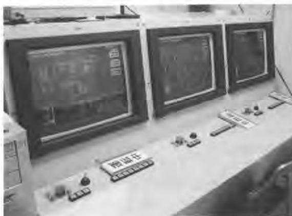
写真-8. 中央運転室・制御盤
