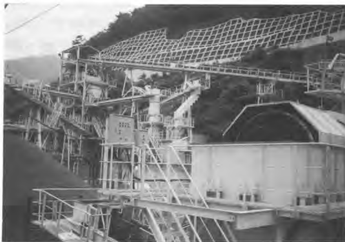
写真-1. 姉川ダムの骨材プラント (洗浄設備及び二、三次破碎設備)
