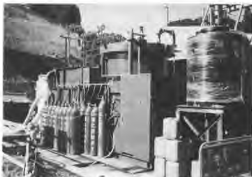
写真-1 「濾過器内蔵型シクナ」搭載 パッケージ濁水処理設備
