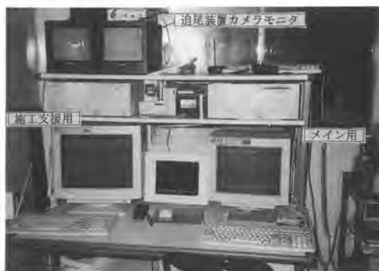
写真-3 操作室システム
