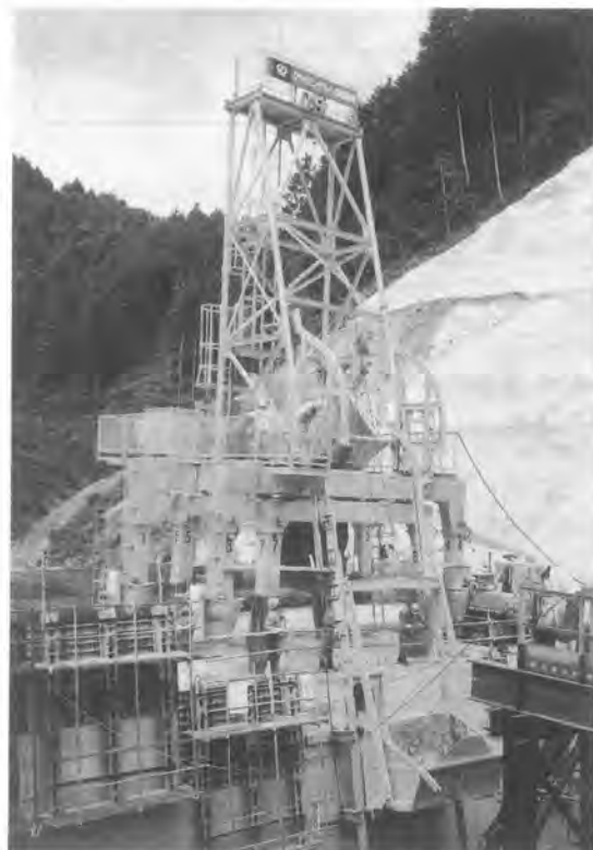
写真-1 設備全景（新設備Ⅰ実証機）
