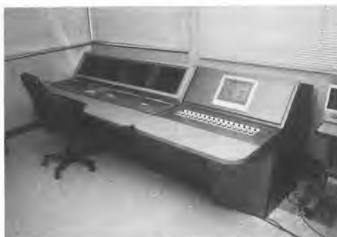
写真-5 集中操作盤
