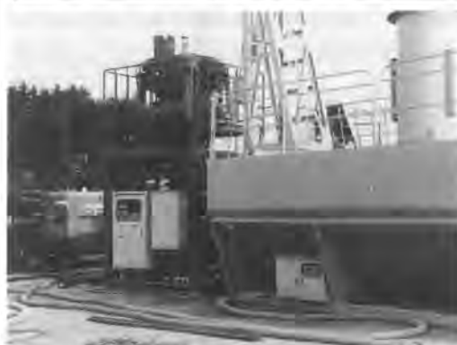
写真-1 PJプラント全貌
