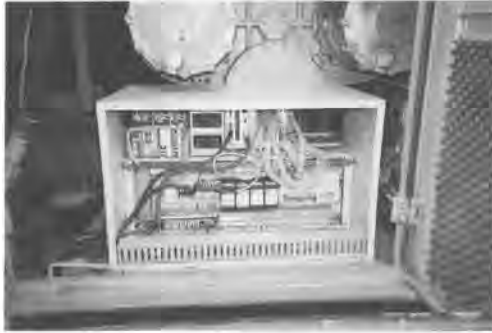
写真-6 システム制御盤
