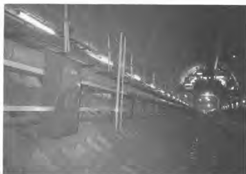
写真-4 配管ラック
