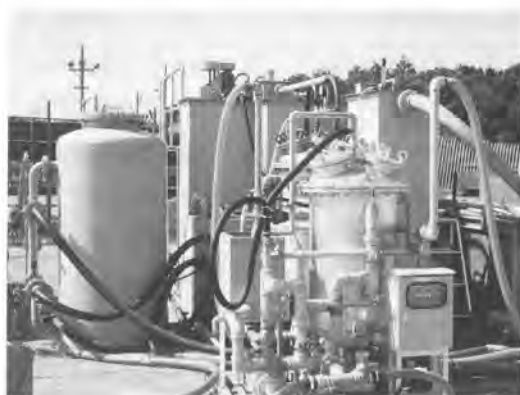
写真-4 濁水処理装置
