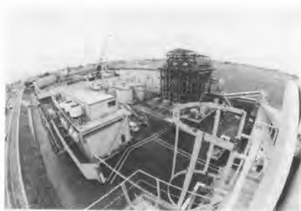
写真—1 泥水処理プラント
