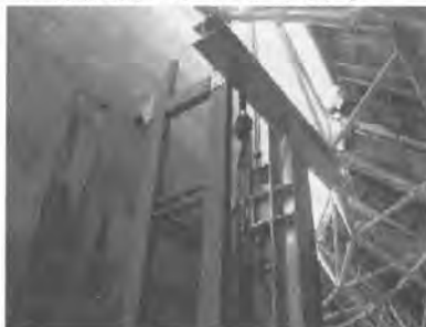
写真-10 振れ止め装置
