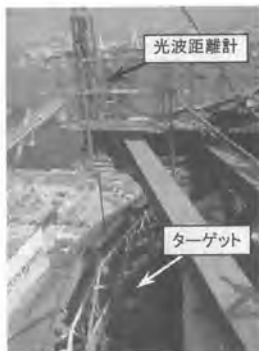
写真-8 揚程計測システム
