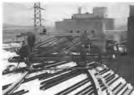
写真3 屋上吊り台車
