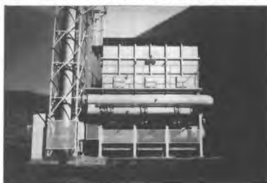
概観写真2 蓄熱燃焼式脱臭装置
