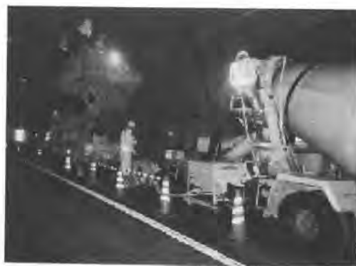
写真-1 実トンネルでの坑内設備全景
