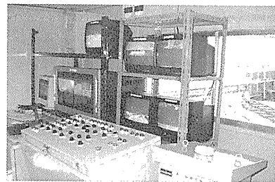
写真-6 遠隔操作室
