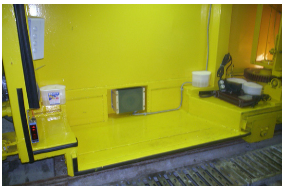
写真 2-8 送電部 (格納台車)
