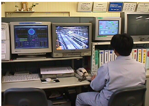
写真1-3 遠隔操作ユニット
